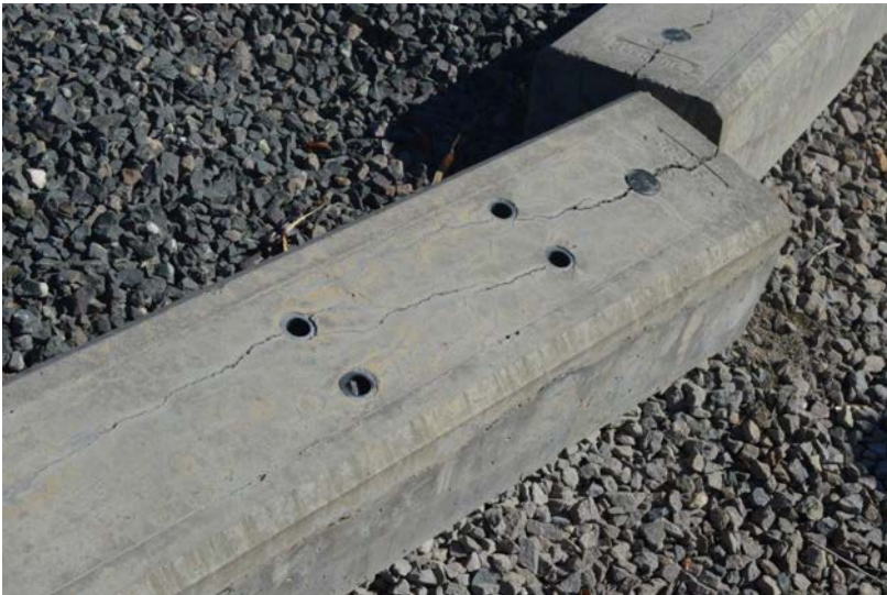
Slika 4: Razpoke vzdolžno z armaturo v železniškem pragu v Romuniji
